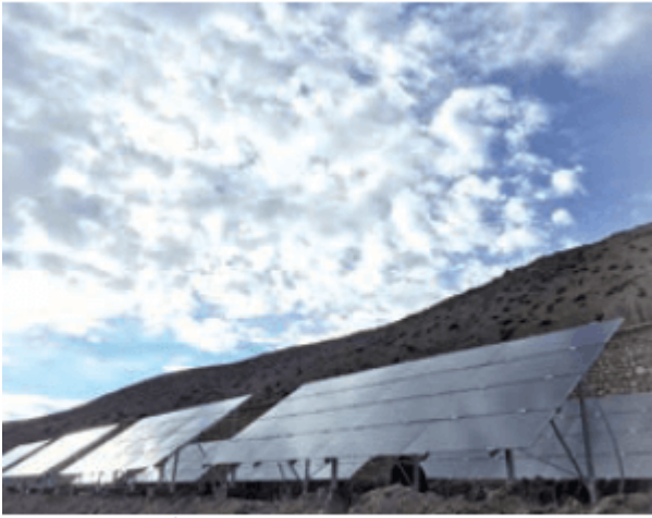
图 1.11 西藏冈底斯藏医学院的太阳能光伏电站
