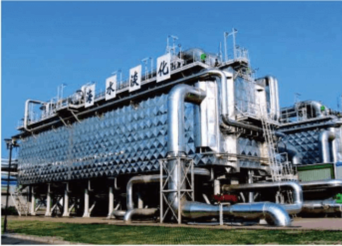
首钢京唐海水淡化工程
