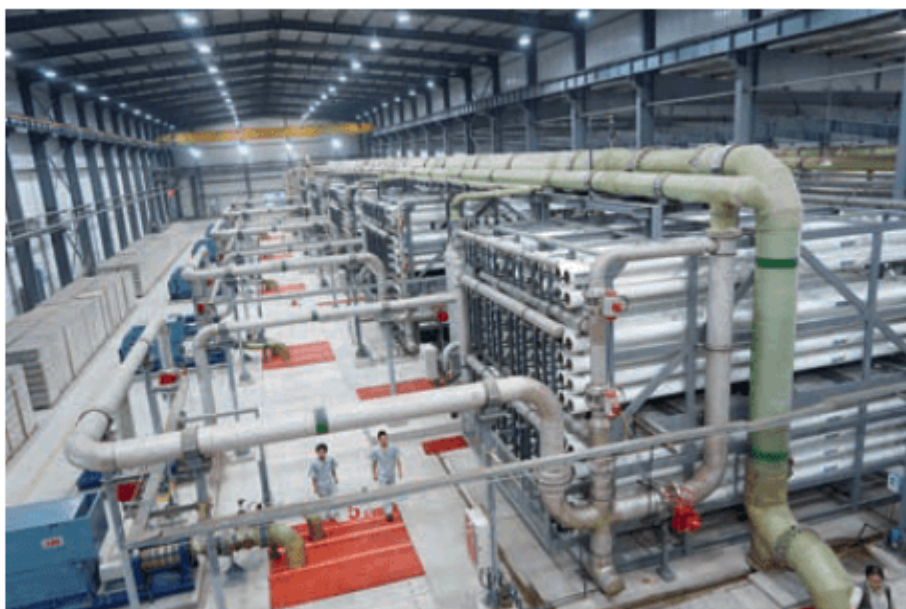
图 3.14 河北唐山曹妃甸的海水淡化车间
