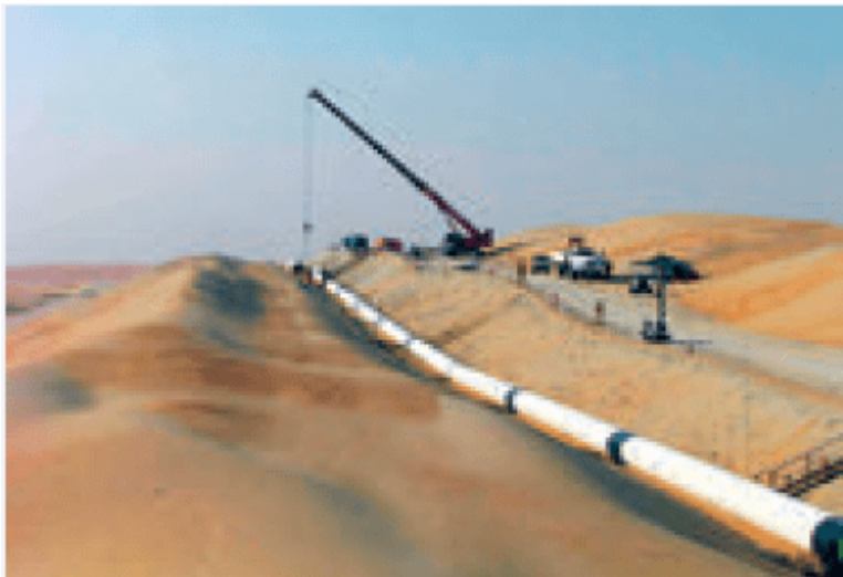
图 2-11 阿联酋人工淡化海水储备库输水管道
