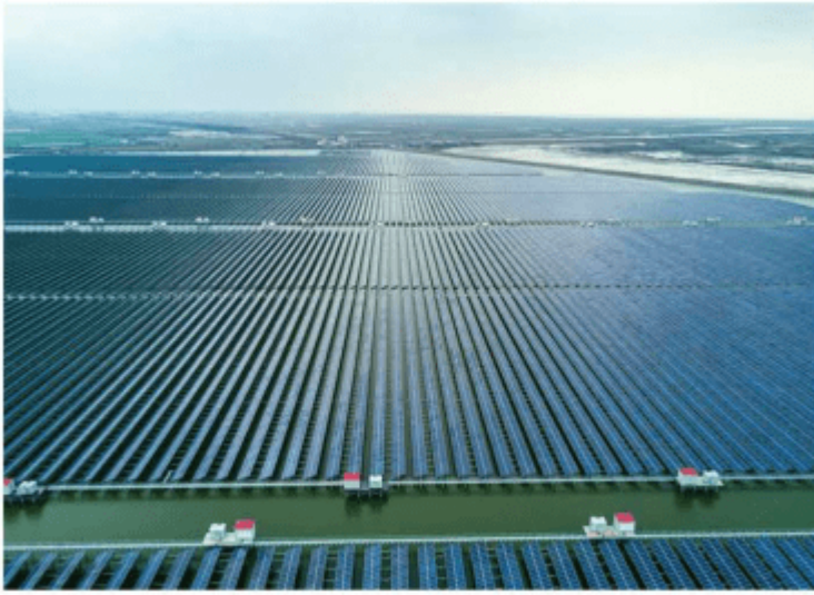
慈溪“渔光互补”光伏发电项目
